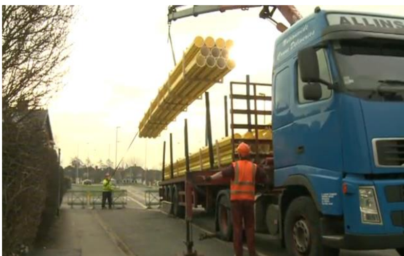
Figura 18 – Descarregamento de tubos lisos em barra, com caminhão munck e um homem-guia.
